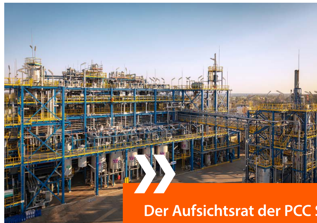
Die Produktionsanlage für hochreine Monochloressigsäure (MCAA) verlängert seit Inbetriebnahme 2016 unsere Chlor-Wertschöpfungskette deutlich.
