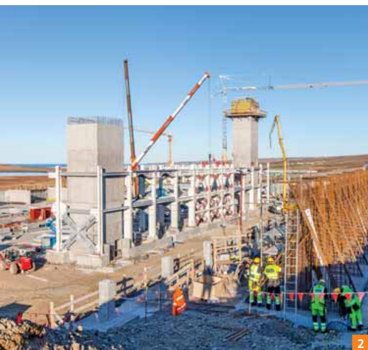
2 Bauarbeiten am Ofengebäude Ende 2016. Mit der Vorbereitung der Kaltinbetriebnahme wird im Spätsommer 2017 begonnen.
