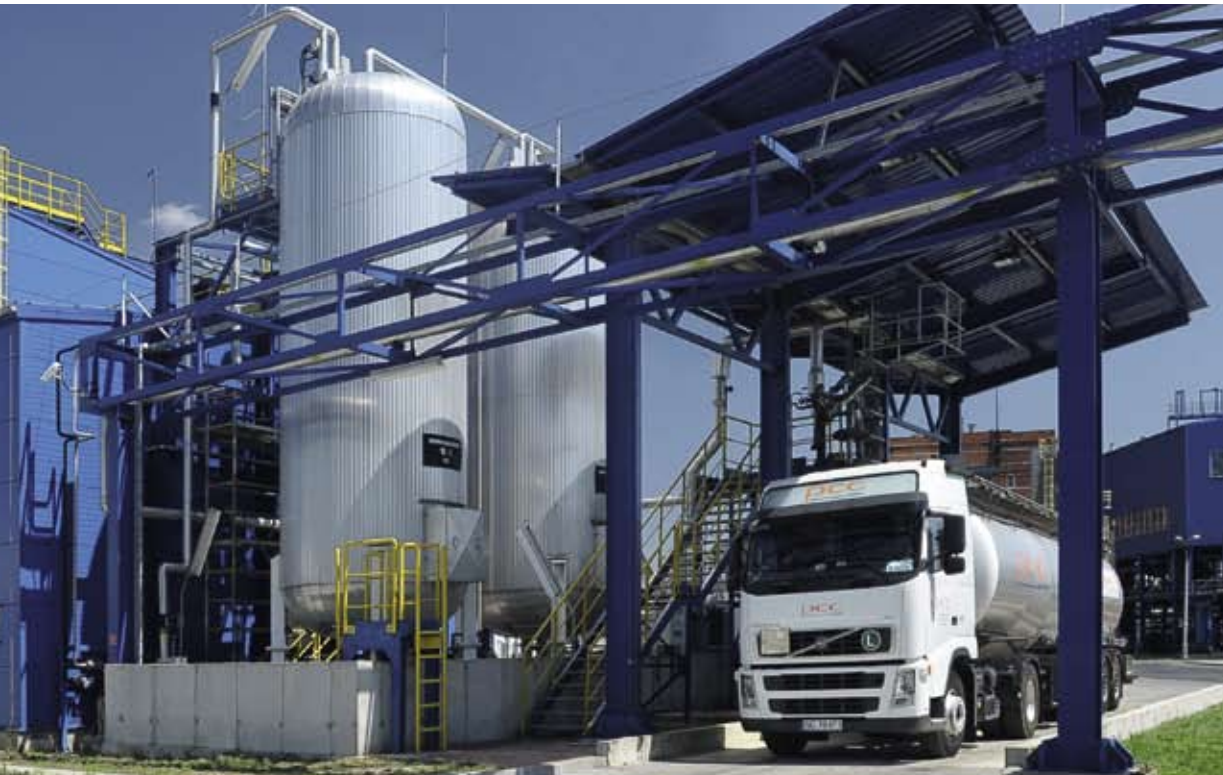
Produktionsanlage der PCC Rokita SA in Brzeg Dolny zur Herstellung von iPol-Polyolen
