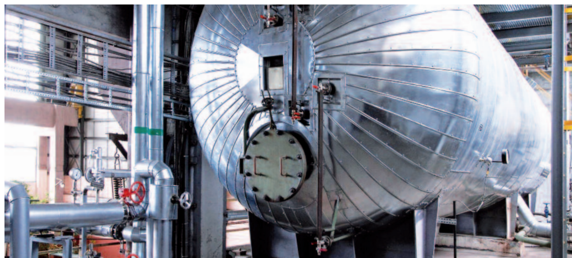
Im Inneren des Heizkraftwerks EC-3, das Ende 2008 mit einer Leistung von 14 MW elektrisch und 80 MW thermisch ans Netz ging.
