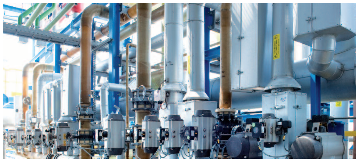
Automatikventile zur Bedienung der Ionenaustauscher der neuen Membranelektrolyse auf dem Werksgelände der PCC Rokita SA in Brzeg Dolny.
