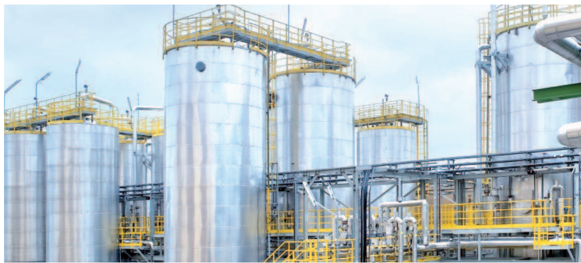
In Polen ist PCC Rokita einziger Hersteller von Tensiden. Die Produktion erfolgt unter anderem in der neuen Sulfonierungsanlage 2 in Brzeg Dolny.
