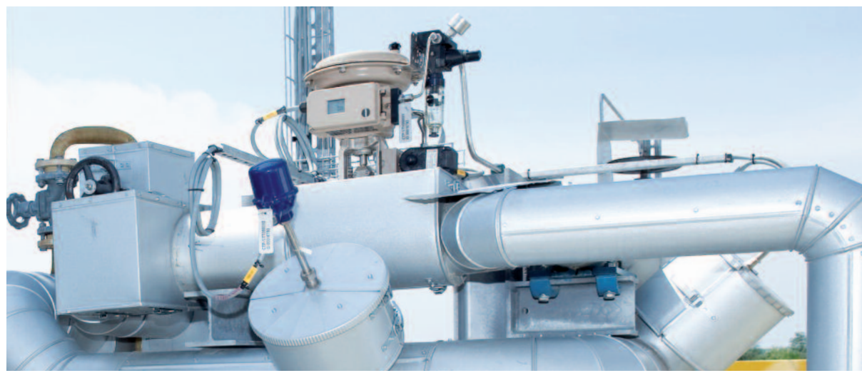
Sicherheitsbehälter für die Chlorgasanlage der Membranelektrolyse auf dem Werksgelände der PCC Rokita SA in Brzeg Dolny.
