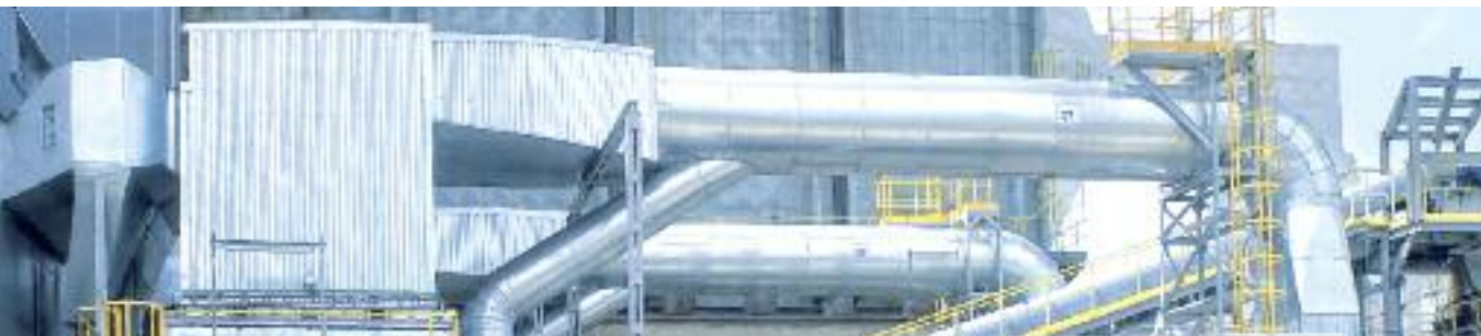
Das im Oktober 2008 in Betrieb genommene Heizkraftwerk EC-3 auf dem Werksgelände der PCC Rokita in Brzeg Dolny
