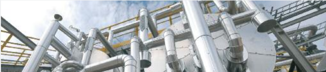
In der neuen Sulfonierungsanlage 2 der PCC Rokita werden rund 30.000 Tonnen anionischer Tenside pro Jahr hergestellt.
