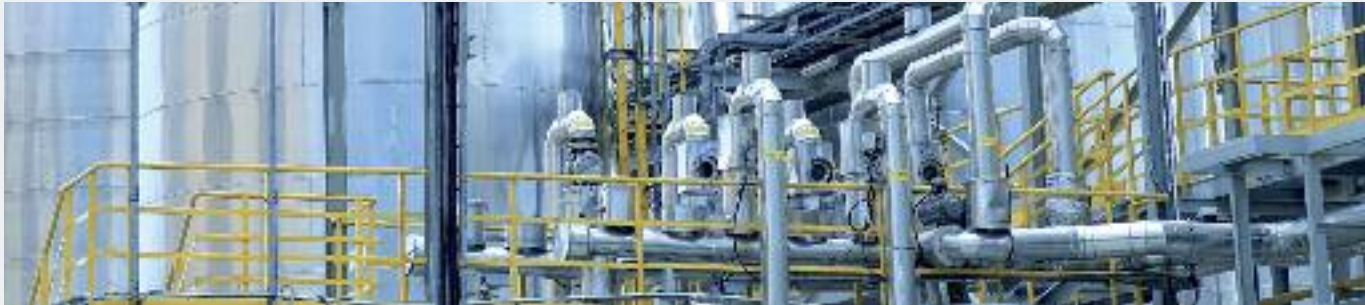
In Polen ist PCC Rokita einziger Hersteller von Tensiden. Die Produktion erfolgt unter anderem in der neuen Sulfonierungsanlage 2.
