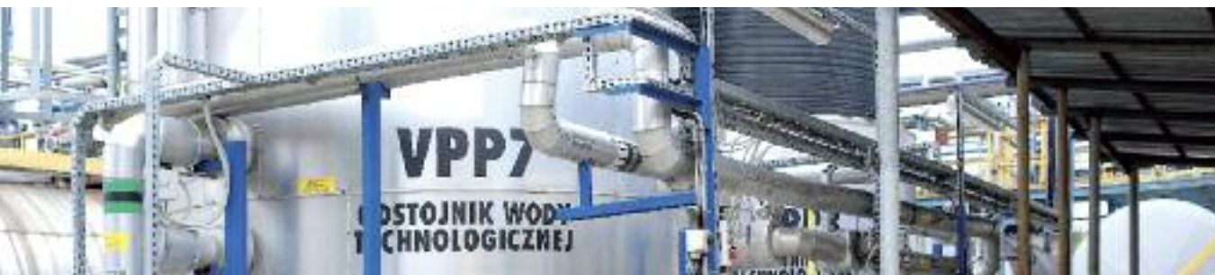
Neue Prozesswasser-Absetzbehälter für den Geschäftsbereich Phosphorchemie bei PCC Rokita
