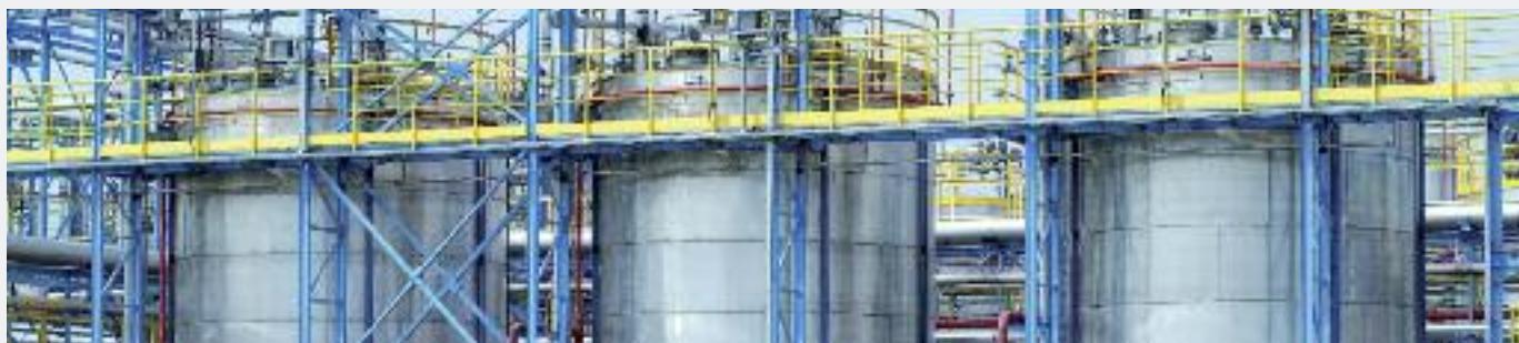
Neue Propylenoxid-Speicherbasis der PCC Rokita – drei Tanks mit einem Volumen von jeweils 160 Kubikmetern
