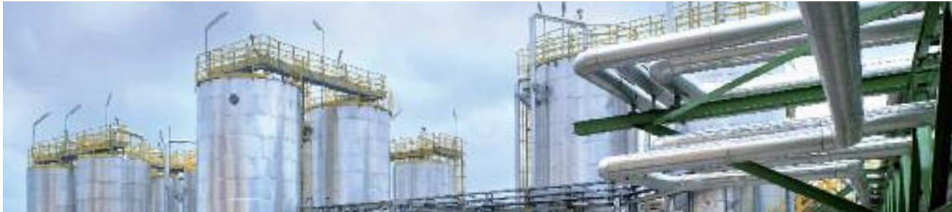
Speichertanks der neuen Sulfonierungsanlage 2 der PCC Rokita in Brzeg Dolny – Inbetriebnahme 2008
