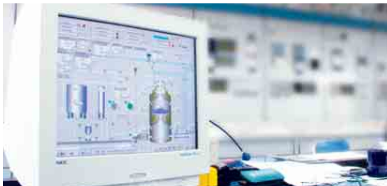
Prozessleitsystem der Produktionsanlage bei PCC Rokita
