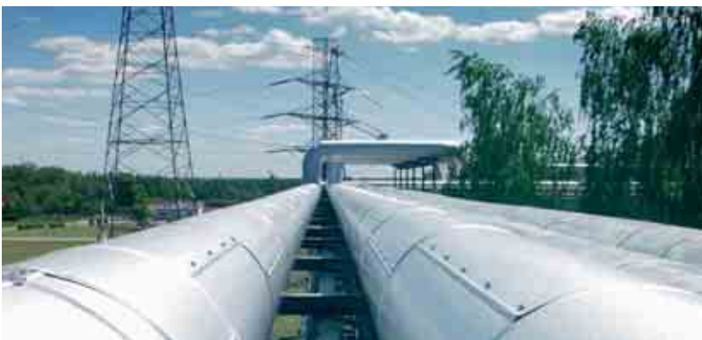
Rohrleitungssystem auf dem Werksgelände der PCC Rokita
