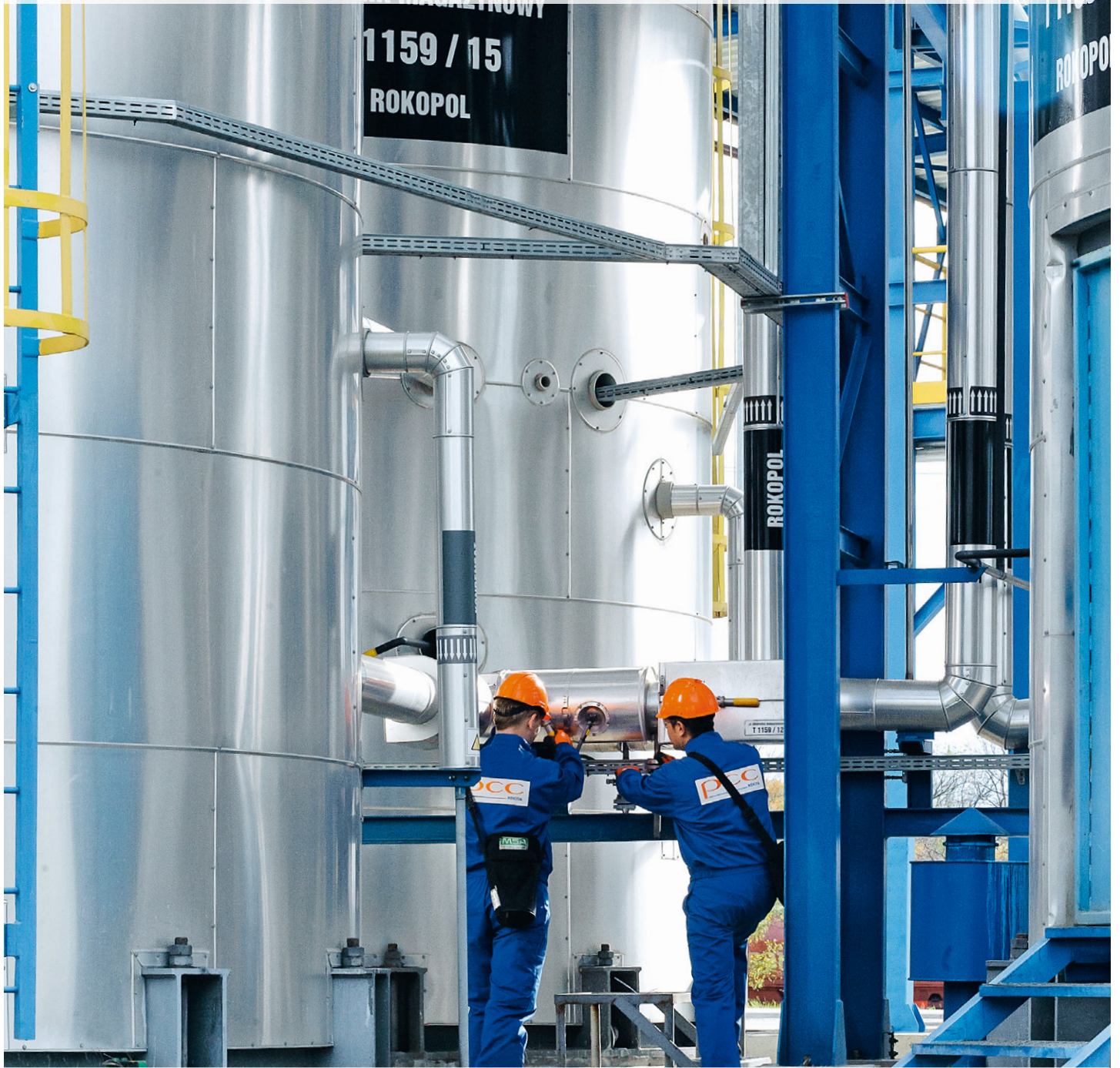
Polyol tank farm at PCC Rokita SA
